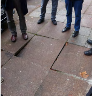
Lose, abgesackte Gehsteig-Platte
